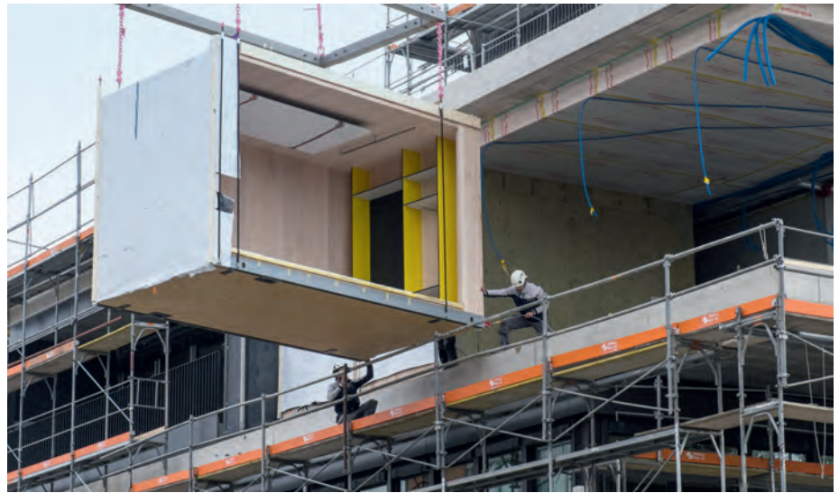
Beim Projekt NEST-Unit werden bereits vorgefertigte Module mit einem Kran platziert – für den kurzen Moment der Montage ist auch eine Absturzsicherung eingeplant (Foto: Roman Keller)
